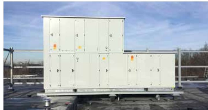
Eén van de door Verstappen van Amelsvoort geplaatste luchtbehandelingskasten.
